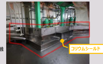
過酷事故発生時に溶融燃料と原子炉格納容器が接触することを防止するコリウムシールドを設置【7号機】
