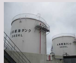
取替後の軽油タンク【7号機】 （タンク鋼板内厚は従来の約4倍）
