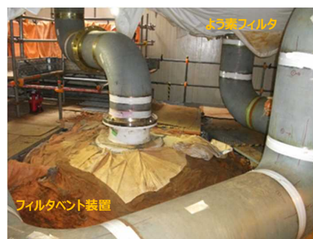
よう素フィルタ廻りの配管（6号機）
