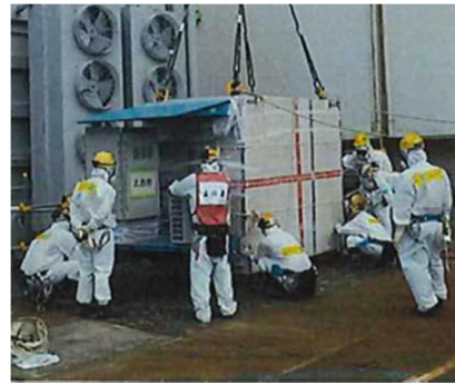
測定装置設置状況
