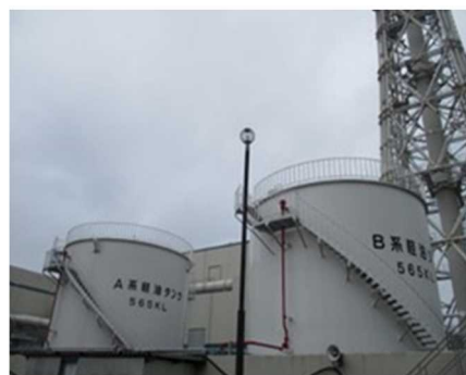
6号機軽油タンク
