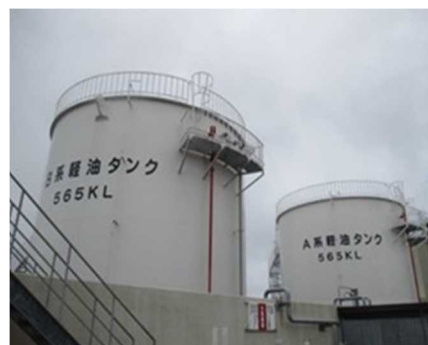
7号機軽油タンク
