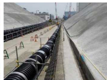
南側ルート配管状況（図：写真①）
