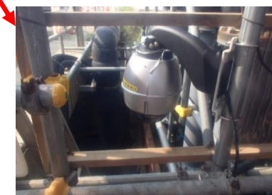
K排水路-C排水路汲み上げ部 (仮堰状況監視カメラ)
