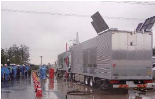
ガスタービン発電機車の起動訓練
