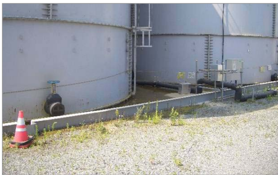
改善状況③：改善前の フランジ型タンク堰周り
