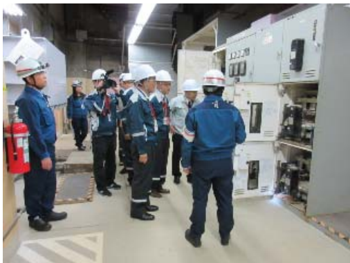
津波により被水した電源盤の確認（1号機）
