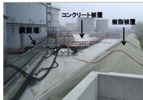
改善状況③：フランジ型タンク 堰の二重化・堰内塗装の状況
