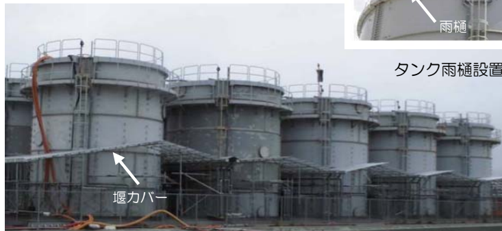
タンク雨水対策状況
