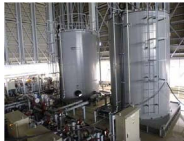
増設多核種除去設備（処理水受入タンク）
