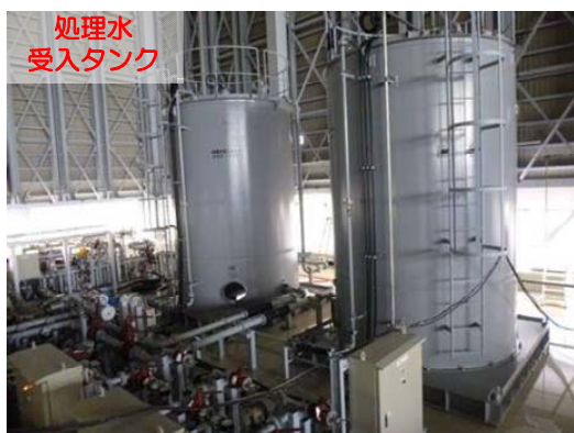
増設多核種除去設備設置状況
