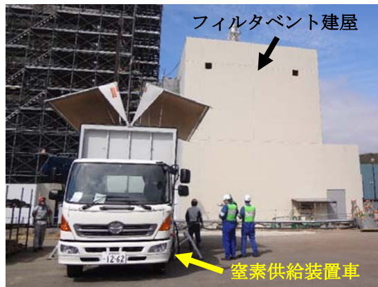
7号機 フィルタベント性能試験の様子
