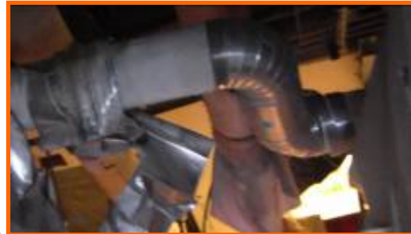
非常用復水器入口蒸気配管
