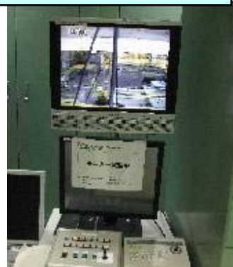
モニター (中央制御室)
