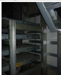
ケーブル トレイ 施工例
