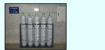
予備窒素ポンベを1プラントにつき5本配備 設置場所(1号機の例) 原子炉建屋付属棟2階 (非管理区域、T.P.12.8m)
