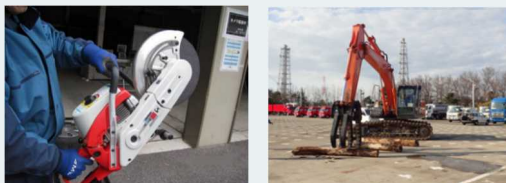
優良提案を実現した「津波等で発生したガレキを除去するための資機材配備【左】エンジンカッター（福島第二）【右】つかみ機を取付けたバックホウ（柏崎刈羽）」
