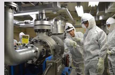
7号機 高圧代替注水系ポンプの設置（柏崎市長視察時）
