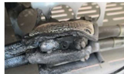
ブレーキレジスタ内の損傷（5月12日）
