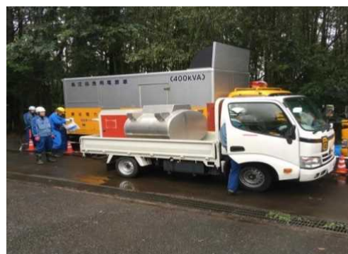
福島第二のタンクローリーから電源車への給油
