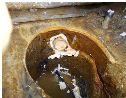
充填材による閉塞をした床ファンネル
