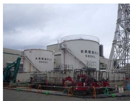
6号機軽油タンク
