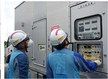
電圧・周波数調整（電源車操作訓練）
