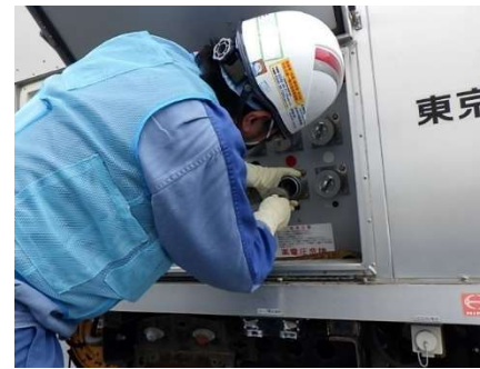
ケーブル接続口確認（電源車操作訓練）
