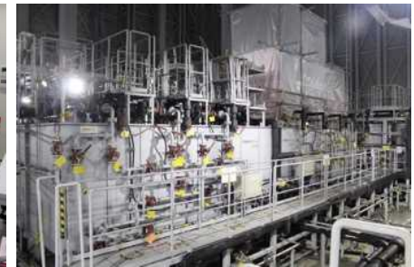
増設多核種除去設備
