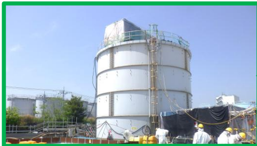
EエリアD1タンク
